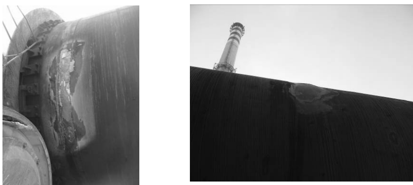
Rys. 11. Przykład przegrzania i deformacji płaszcza pieca na skutek awarii wymurówki
