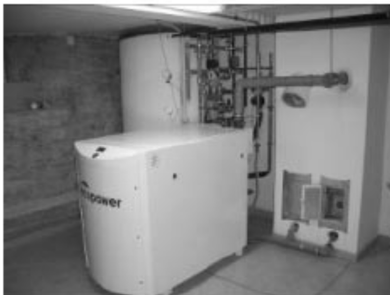
Rys. 8. Zdjęcie instalacji MCHP [7]
