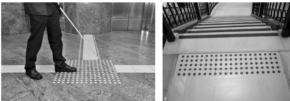
Rys. 3. Wypukłe ścieżki i guzki w posadzce Źródło: [6].
